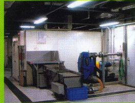
設置例 (東京ドームホテル)
