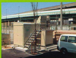
設置例 (東大阪学校給食センター)
