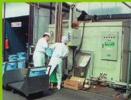
設置例 (北村山公立病院)
